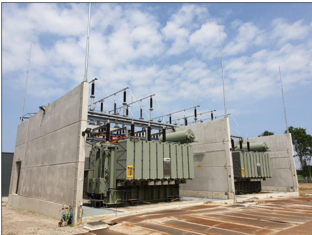
Figuur 2.4: impressie trafocellen.
